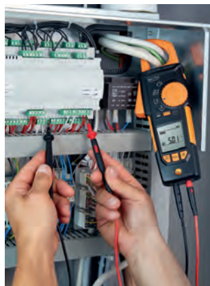
Měření napětí v rozvodné skříně tepelného čerpadla se zavěšeným měřícím přístrojem.
