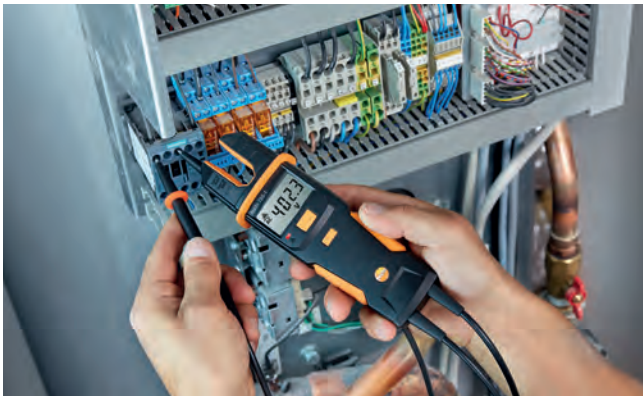
Testování napětí na tepelném čerpadle s testo 755 .
