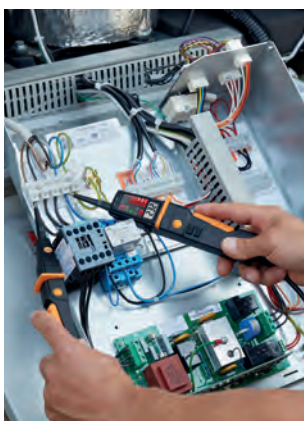
Měření napětí na kompresoru.
