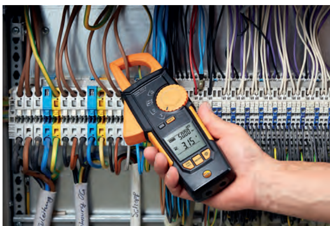
Měření proudu v rozvodné skříně.
