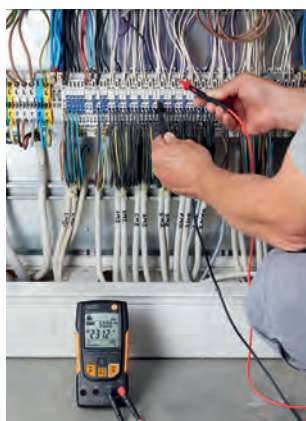
Testování napětí v rozvodné skříni.
