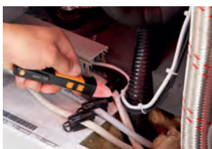
Rychlý test napájecího napětí na kompresoru.
