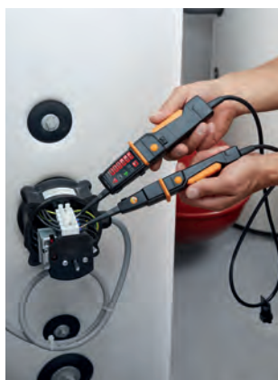
Měření napětí na kotli.
